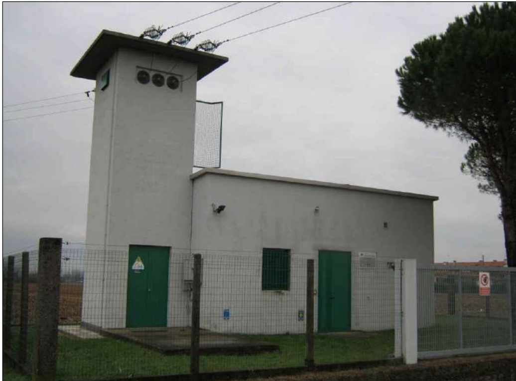
Pozzo 342 – impianto pluvirriguo Passariano
