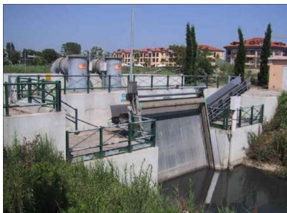
Idrovora Rotta Primero (Grado)
