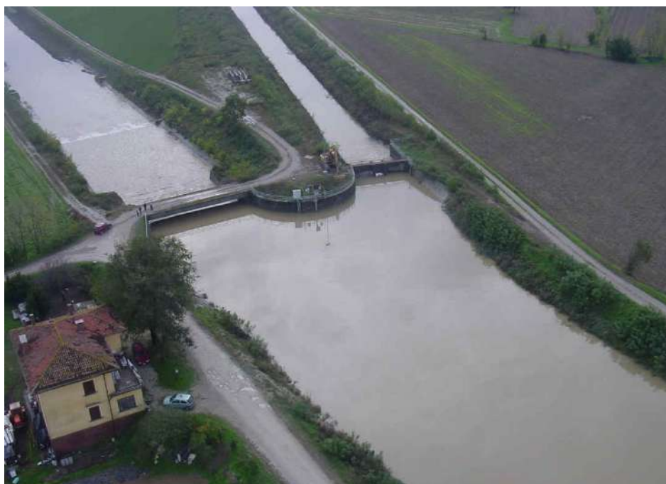
Immagine aerea del manufatto partitore a monte della cassa di espansione, durante un evento di piena
