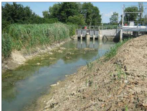
Idrovora Ara (Terzo d'Aquileia)
