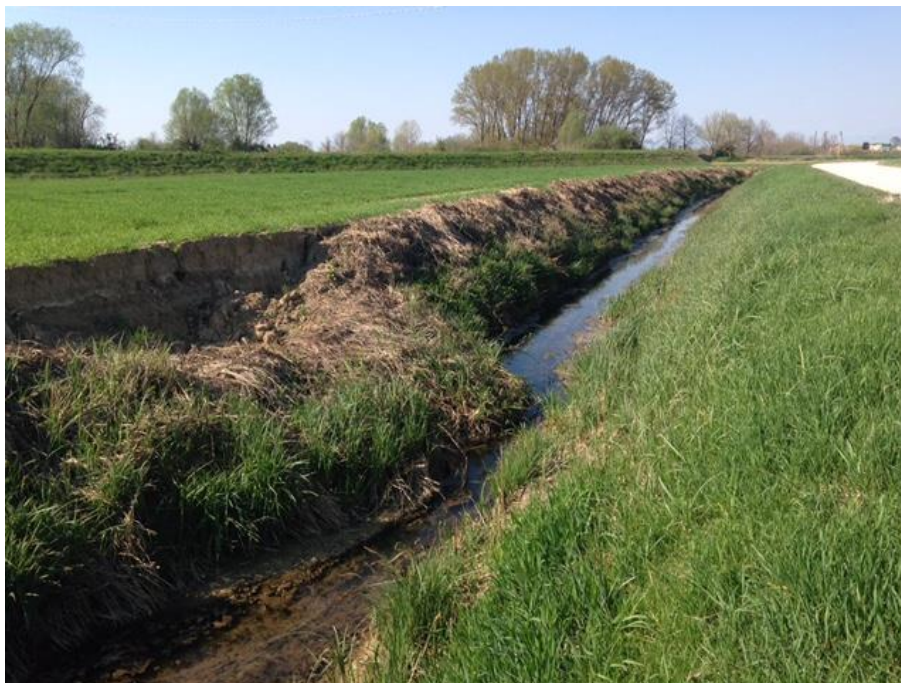
Figura 12 Esempio dei danni causati ai canali di bonifica dalle nutrie
