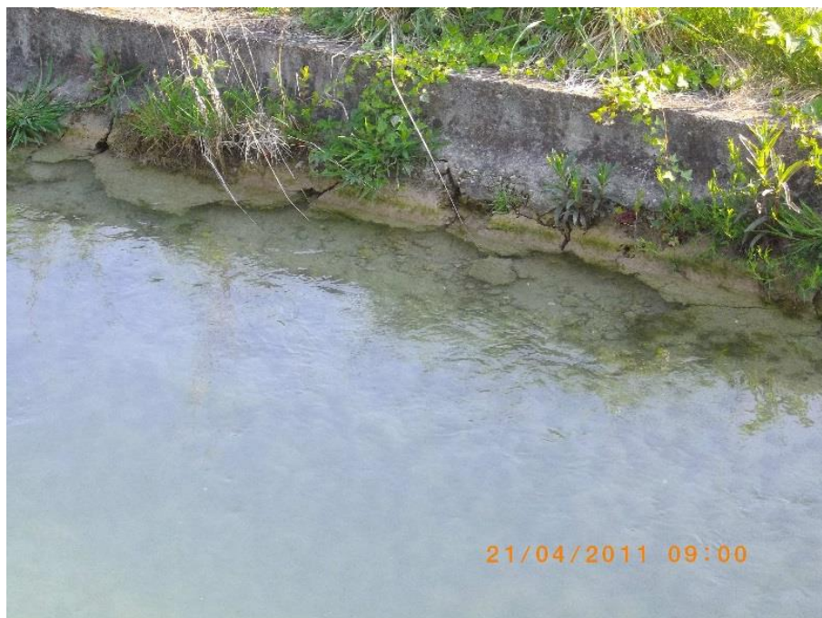
Figura 6 Canale di San Vito, tratta con rivestimento da ripristinare
