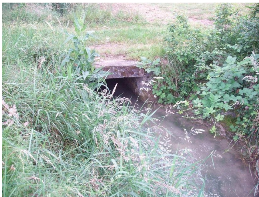
Figura 8 Canale di Passons, esempio di manufatto inadeguato
