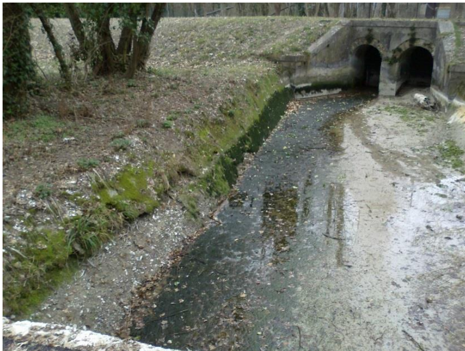
Figura 3 Roggia di Carpacco, nodo idraulico e tratta di cavo roiale che necessitano di ripristino
