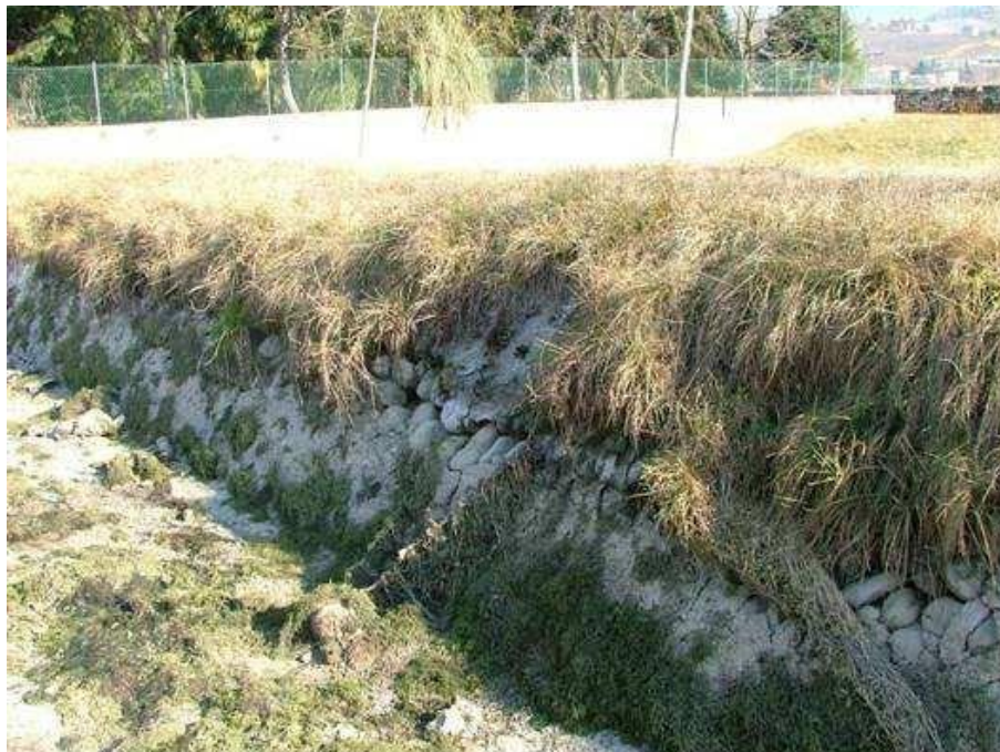
Figura 9 Roggia Principale, sponda ammalorata
