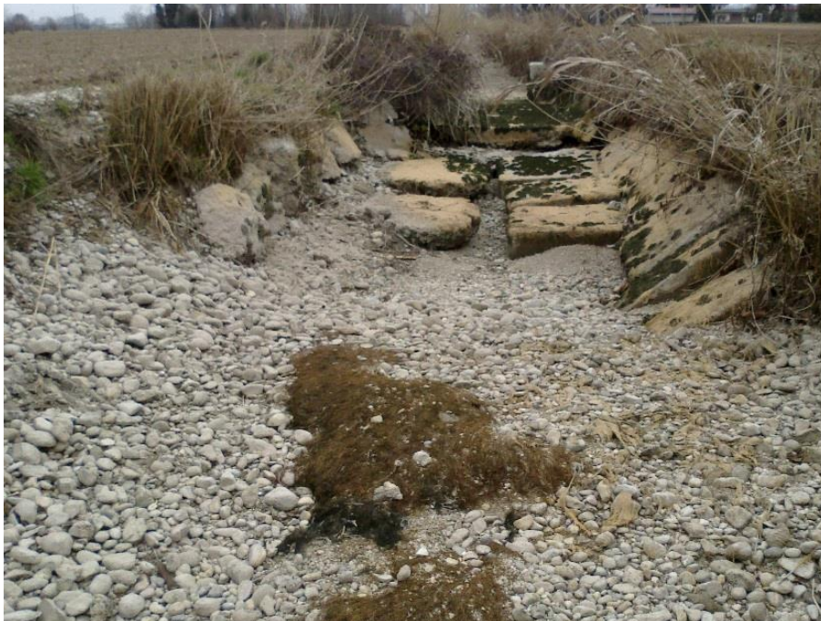
Figura 3 Roggia di Carpacco, salti di fondo da ripristinare
