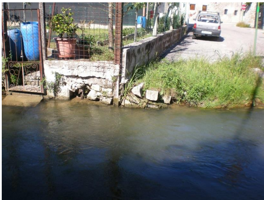
Figura 10 Roggia Cividina, erosione delle sponde
